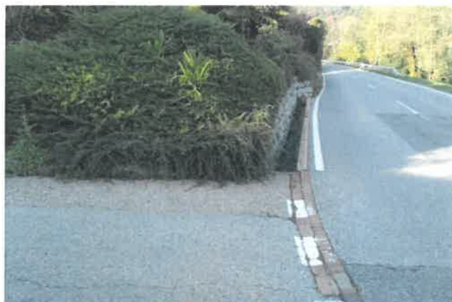
Figura 3 Imbocco su via Brocasg con canaletta lungo la strada da eliminare per far posto al marciapiede
