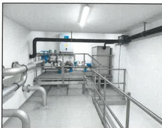
Locale tecnico serbatoio
