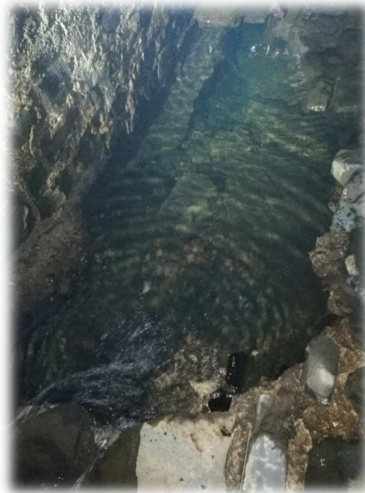
Figura 20 – Rottura già documentata al termine della prima indagine
