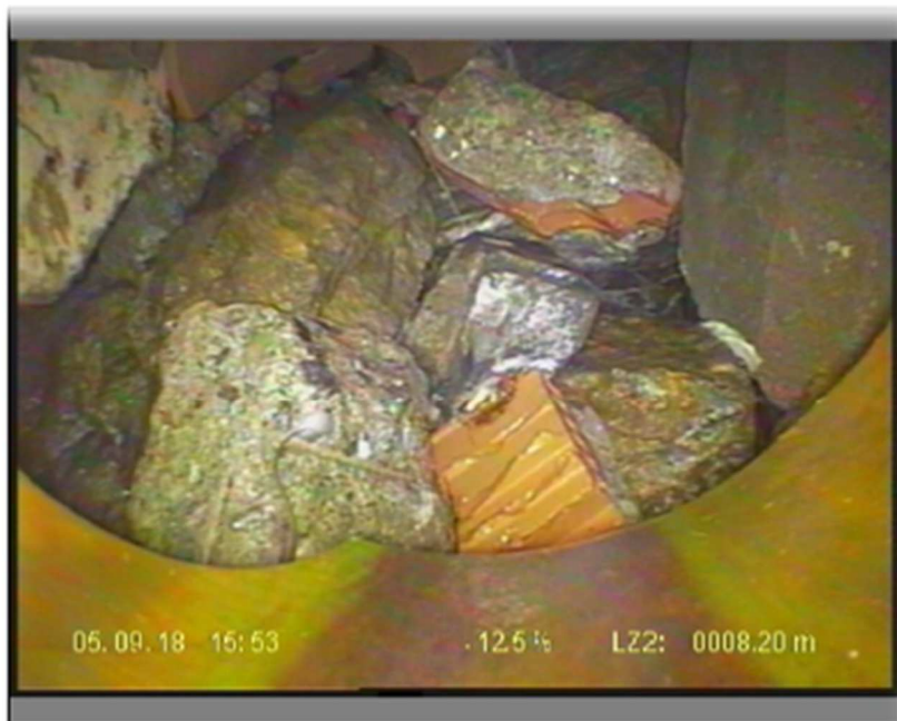
Fotografia: 5_5_9_A.JPG 8,2m, Grave rottura parete tubazione, Longitudinale, circolare, dal 12 al 12 ore
