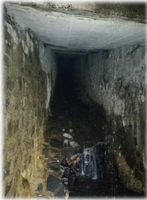
Figura 9 – Grave rottura del fondo, differenziazione pavimentazione, punto d'interruzione prima indagine
