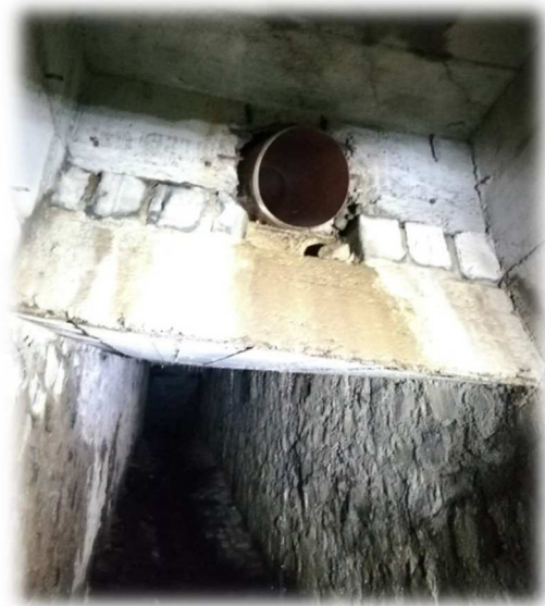
Figura 8 – Immissione nel riale sotterraneo della condotta DN500 danneggiata
