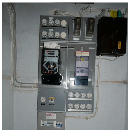
Il quadro elettrico principale
