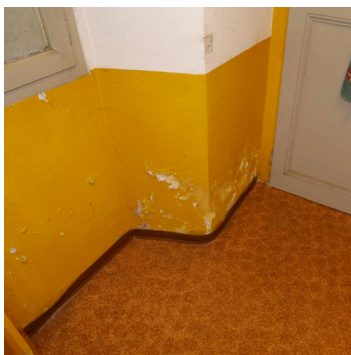
Tracce di umidità ascendente
