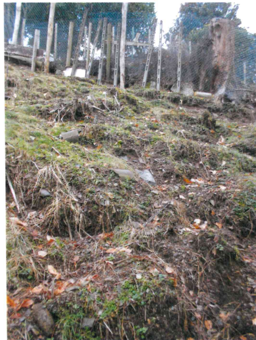
FOTO 8 – Sponda destra del riale in testata. È presente un'estesa zona instabile in detrito che potrebbe facilmente staccarsi e finire nell'alveo del corso d'acqua.
