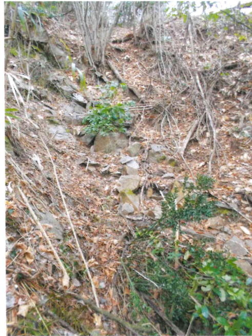
FOTO 2 – Tratto di riale con sponde in materiale sciolto, modesti accumuli detritici in alveo ed anche piccoli blocchi rocciosi derivanti da crolli dagli affioramenti rocciosi che si affacciano sul riale.
