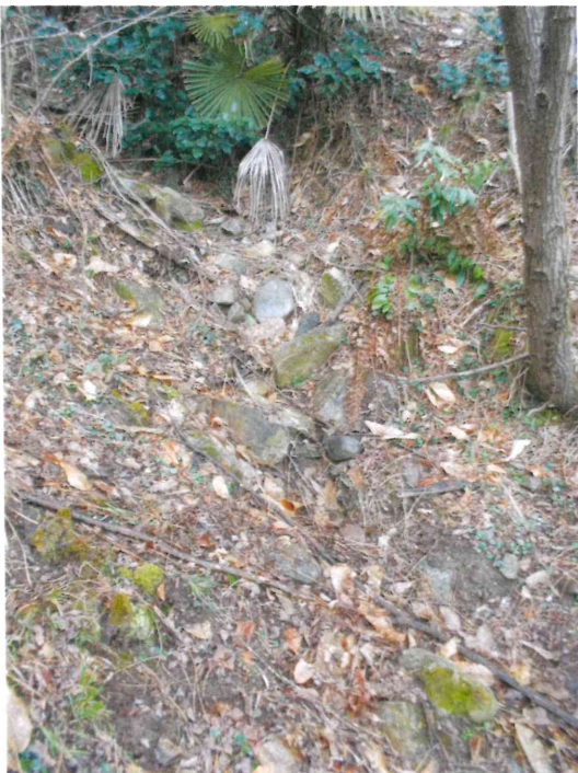
FOTO 3 – Tratto di riale con sponde poco incise in materiale sciolto e accumuli di detrito in alveo non particolarmente rilevanti.
