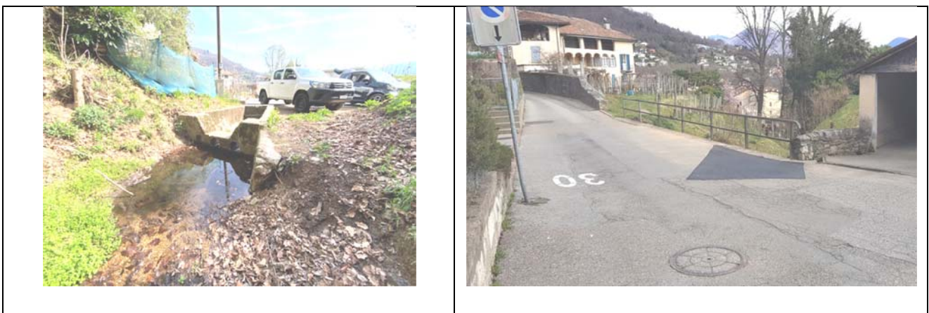
Figura 1 Situazione e foto zona incanalamento, il rappazzo della pavimentazione indica il punto del sondaggio eseguito dall'UTC
