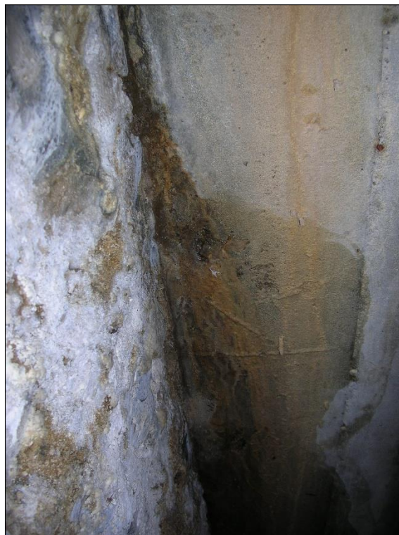
Foto 7: d4/d5 – Presenza d'umidità e corrosione lungo il filo soletta.
