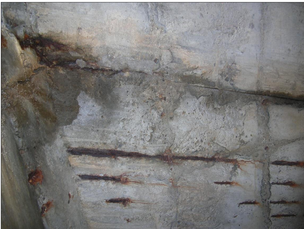
Foto 38: d24 – Vista del ferro d'armatura sul filo soletta.
