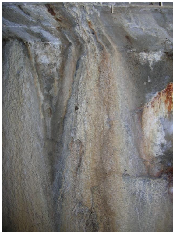
Foto 51: d32 – Umidità + rotture verticali lungo l'intera sezione.
