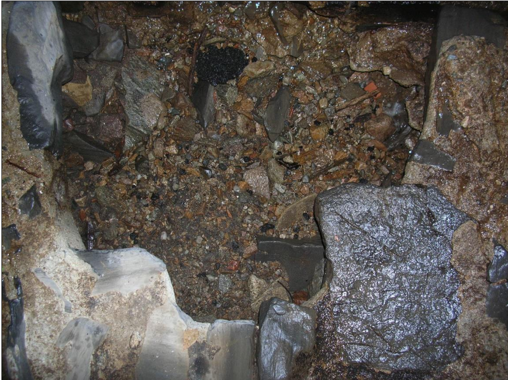
Foto 11: d7 – Rottura della pavimentazione.
