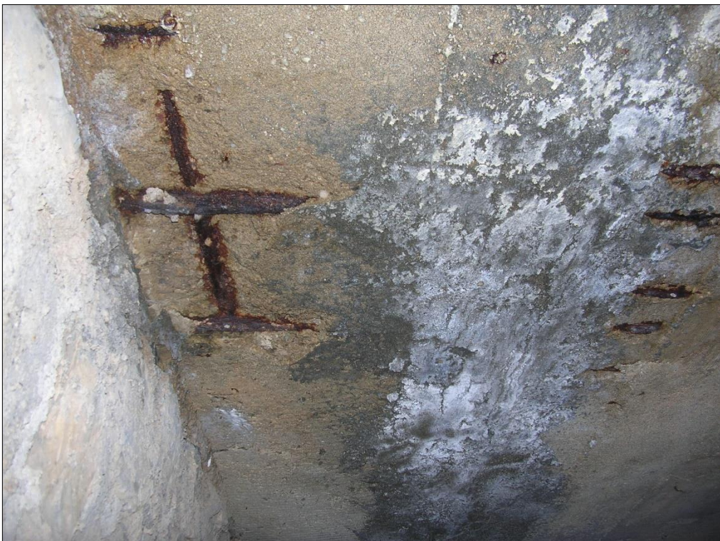
Foto 26: d18 – Ferri d'armatura a vista sul filo soletta.
