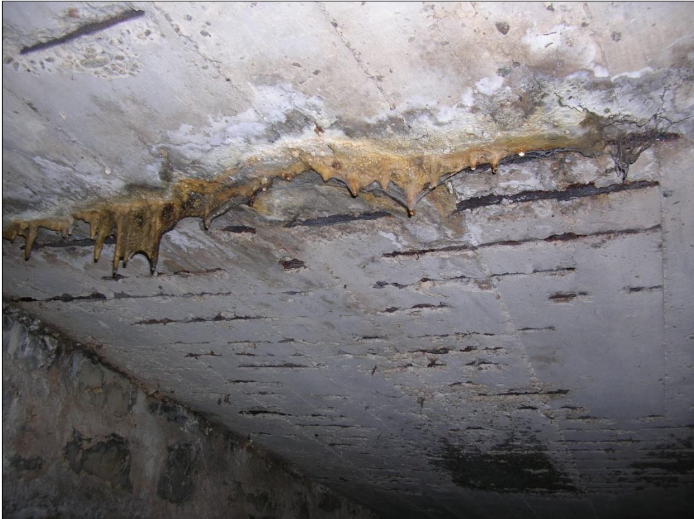
Foto 13: d9/d10 – Ferri d'armatura a vista sul filo soletta.
