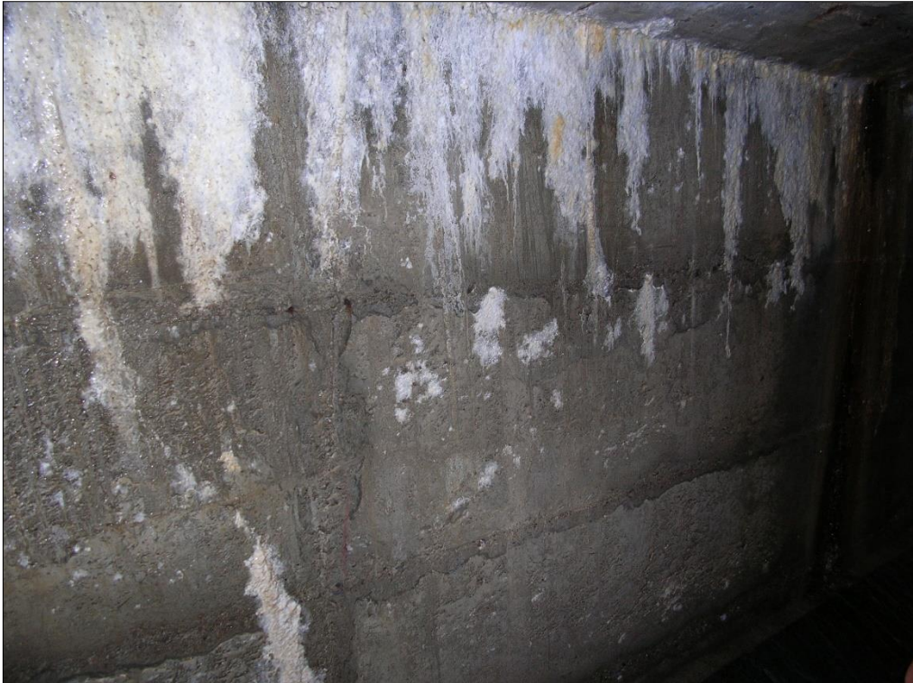
Foto 43: d28 – Presenza di muffa lungo la parete in elevazione.
