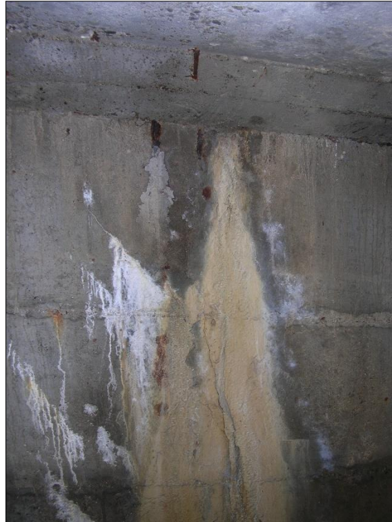
Foto 49: d31 – Umidità + rotture verticali lungo la parete.
