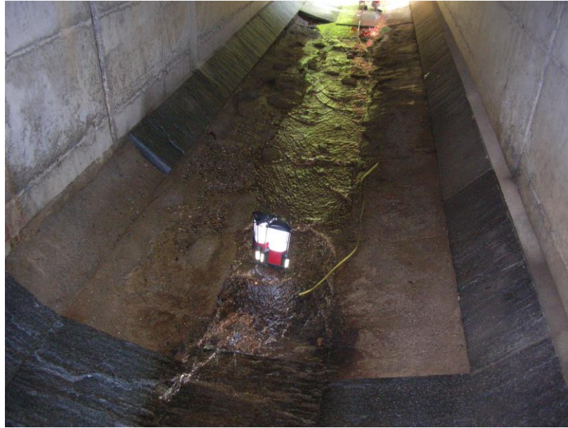
Figura 6: vista di una porzione di canale in cui le beole posate sono ormai completamente assenti.
