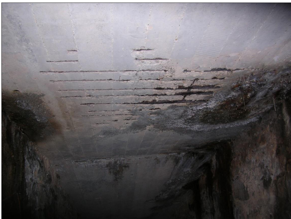
Foto 20: d15 – Ferri d'armatura a vista sul filo soletta.
