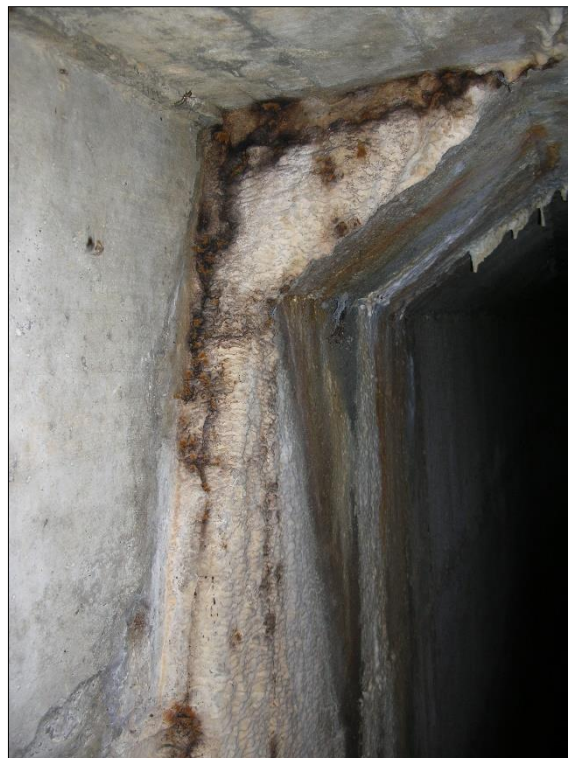
Foto 50: d32 – Umidità + rotture verticali lungo l'intera sezione.
