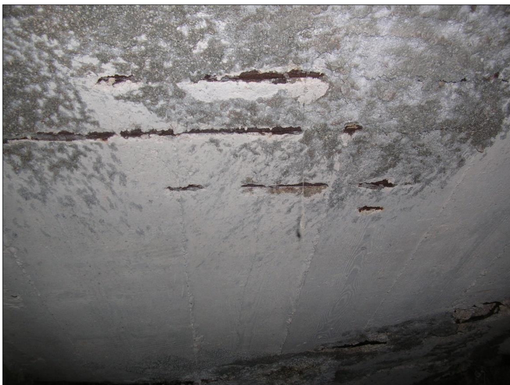
Foto 24: d17 – Ferri d'armatura a vista sul filo soletta.
