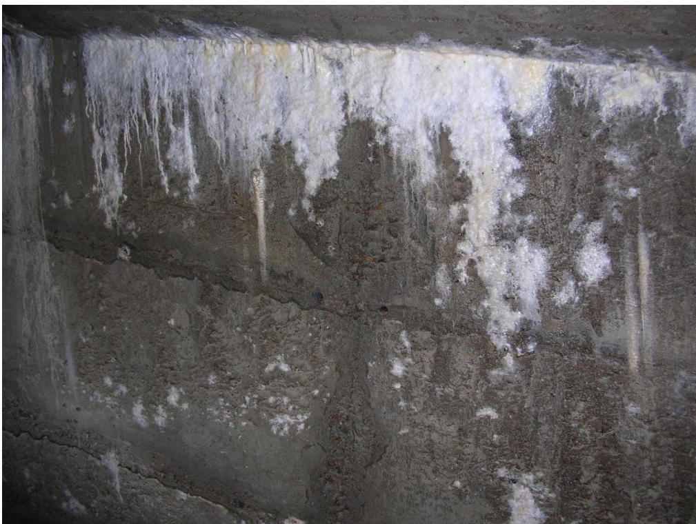
Foto 42: d28 – Presenza di muffa lungo la parete in elevazione.
