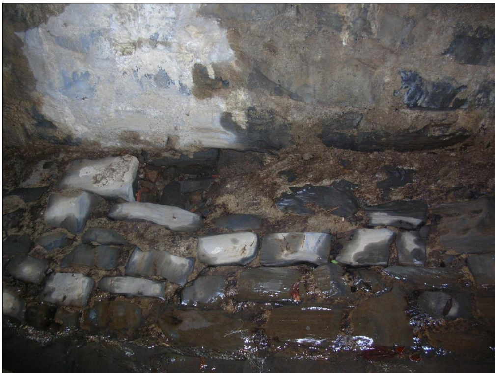
Foto 19: d14 – Rottura della pavimentazione.
