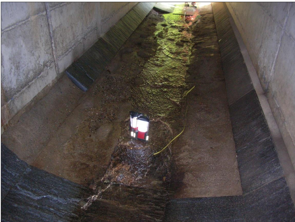
Foto 54: – Vista dell'assenza della pavimentazione (lastre).
