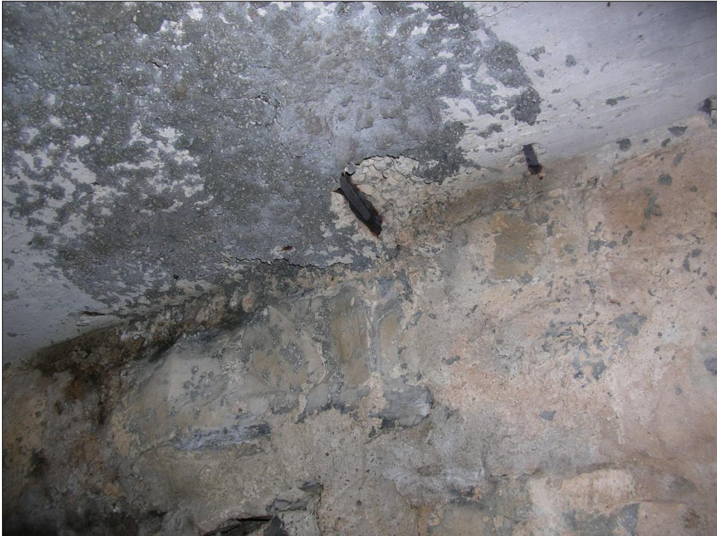
Foto 17: d12 – Ferri d'armatura a vista sul filo soletta.
