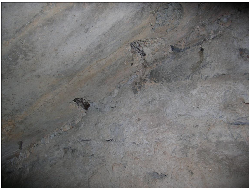
Foto 4: d1 – Ferro d'armatura a vista sul filo soletta.
