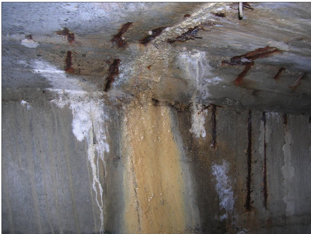
Foto 45: d30 – Vista del ferro d'armatura lungo l'intera sezione.
