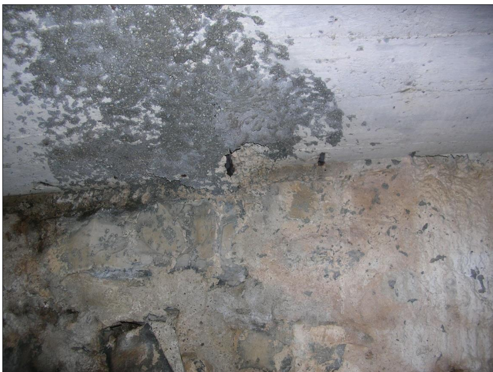
Foto 16: d12 – Ferri d'armatura a vista sul filo soletta.
