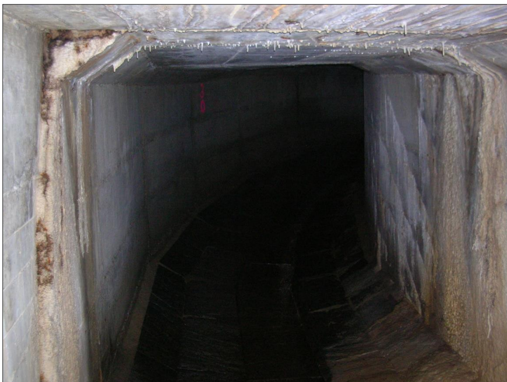
Foto 52: d32 – Umidità + rotture verticali lungo l'intera sezione.
