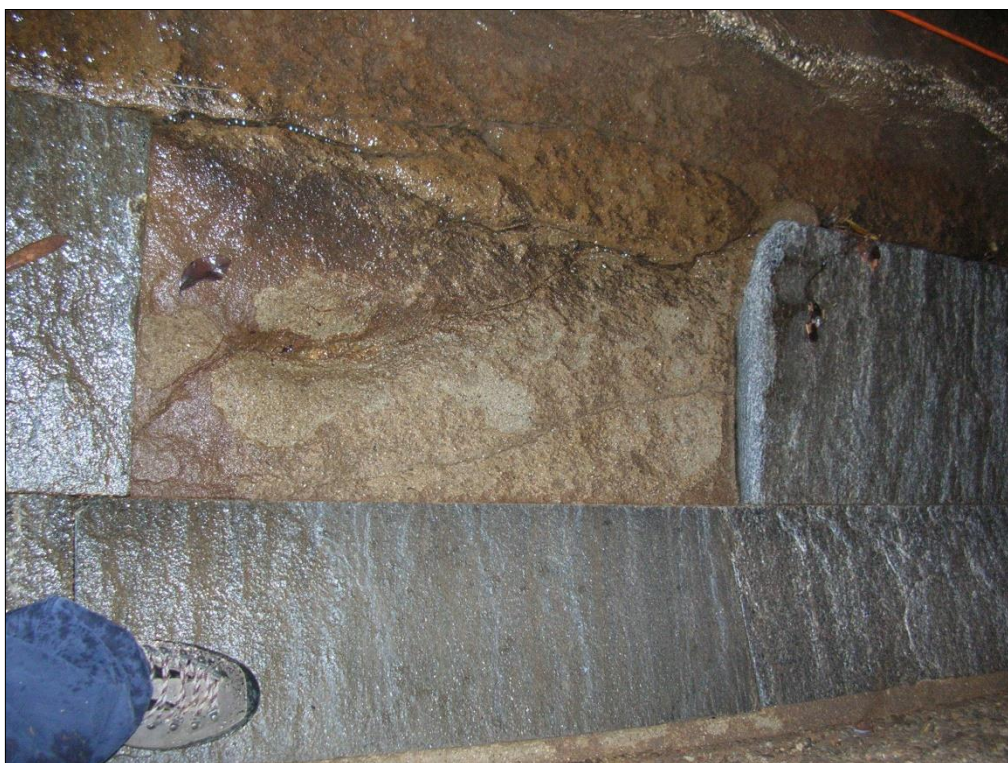
Foto 34: d20 – Vista dell'assenza di una lastra della pavimentazione.
