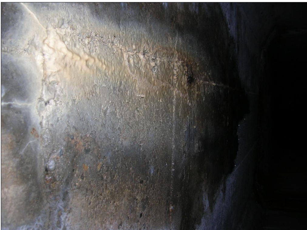
Foto 44: d29 – Presenza d'umidità lungo la parete in elevazione.
