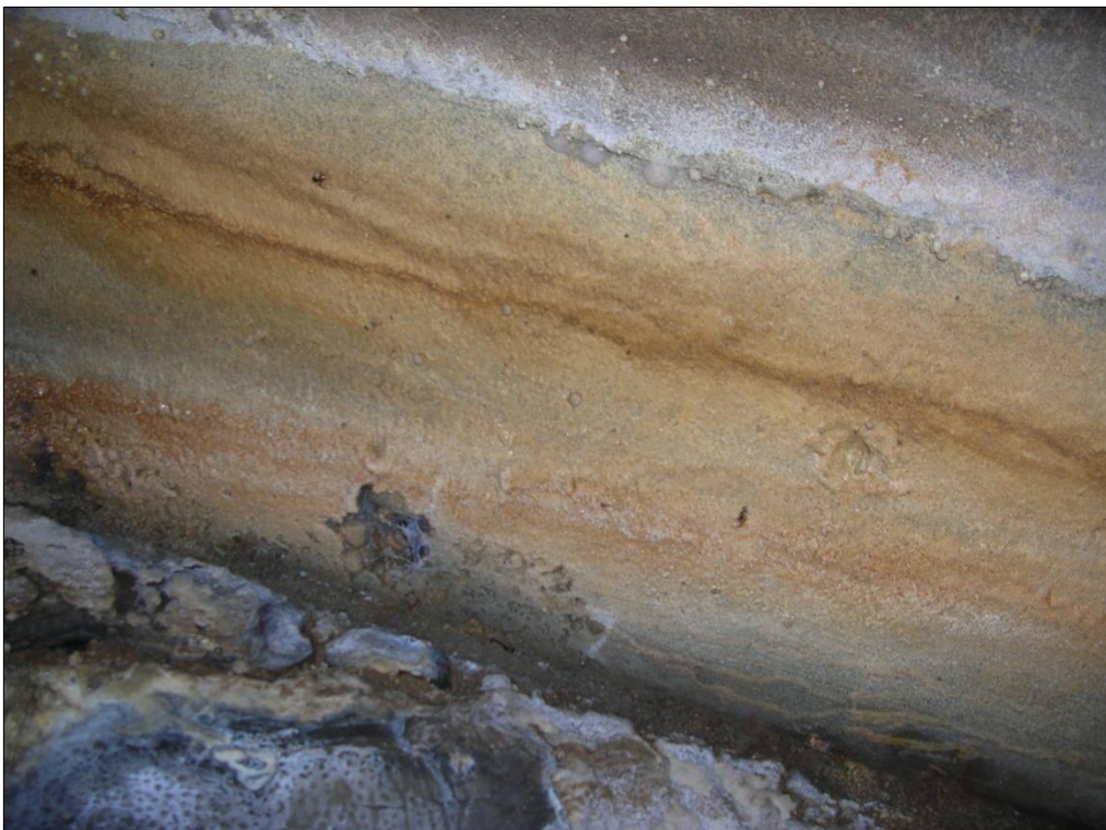
Foto 6: d4/d5 – Rottura, presenza d'umidità e corrosione sul filo soletta.
