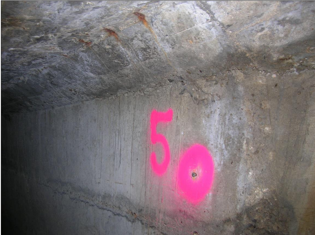
Foto 41: d27 – Corrosione sul filo soletta.
