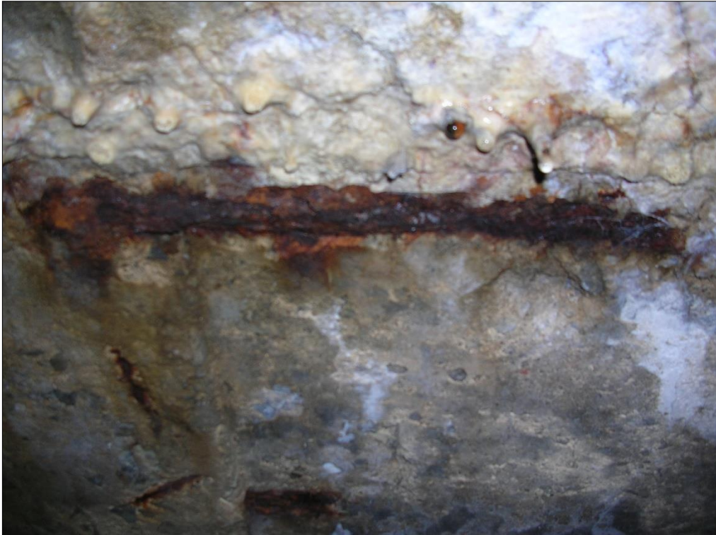
Foto 47: d30 – Vista del ferro d'armatura lungo l'intera sezione.
