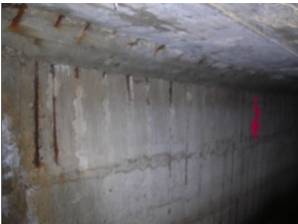
Foto 46: d30 – Vista del ferro d'armatura lungo l'intera sezione.
