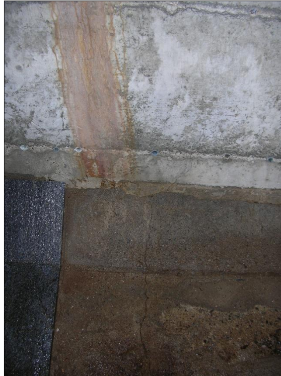
Foto 53: d33 – Fessurazione sulla pavimentazione.
