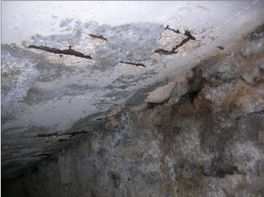
Foto 25: d17 – Ferri d'armatura a vista sul filo soletta.
