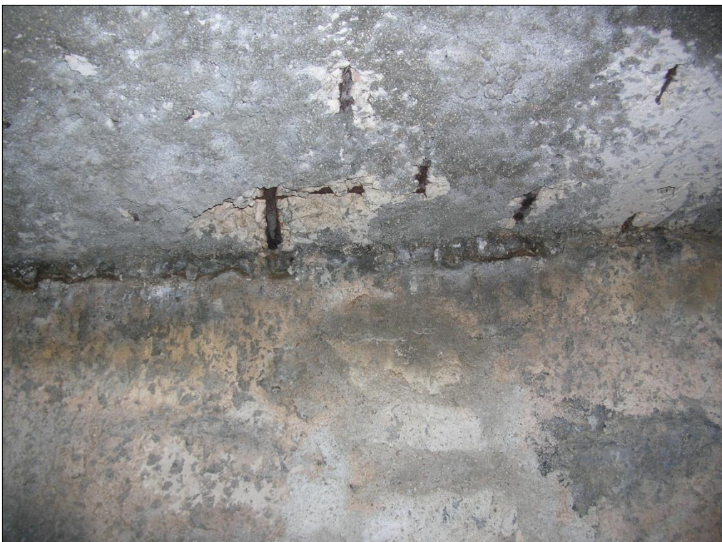
Foto 18: d13 – Ferri d'armatura a vista sul filo soletta.
