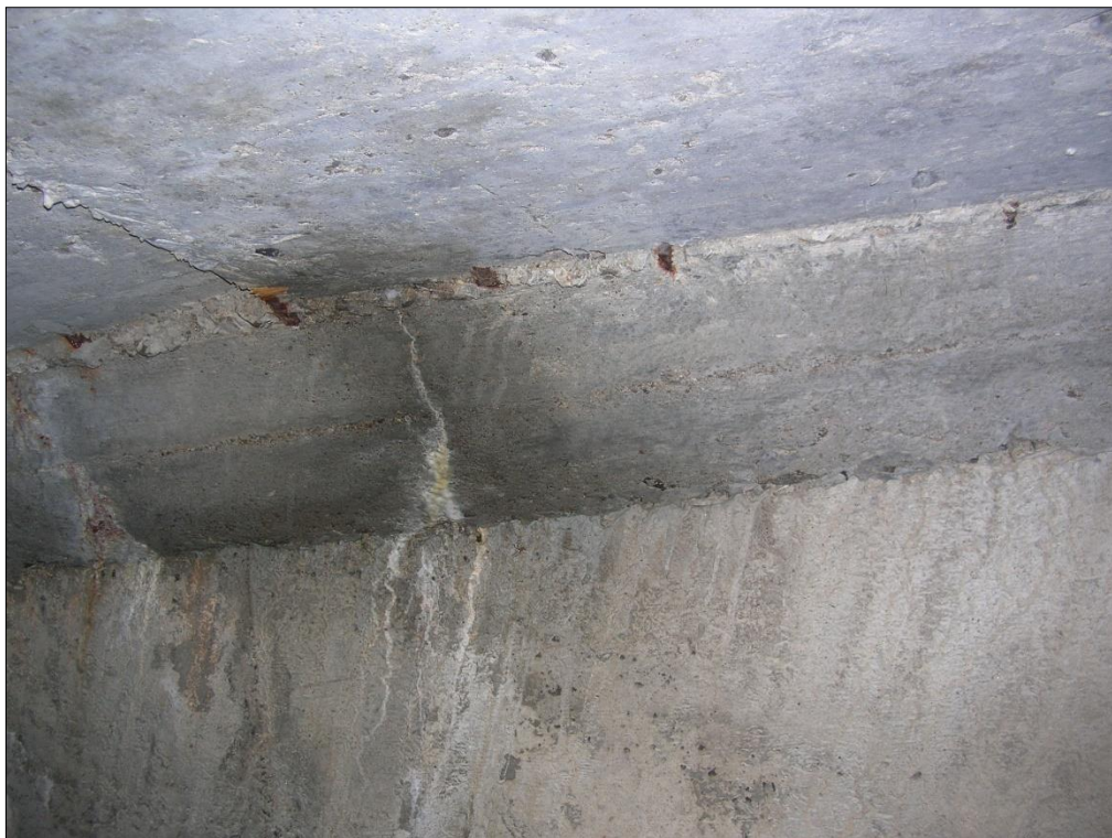
Foto 39: d25 – Vista del ferro d'armatura sul filo soletta.
