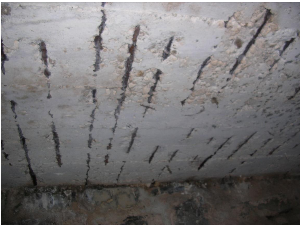
Foto 14: d9/d10 – Ferri d'armatura a vista sul filo soletta.
