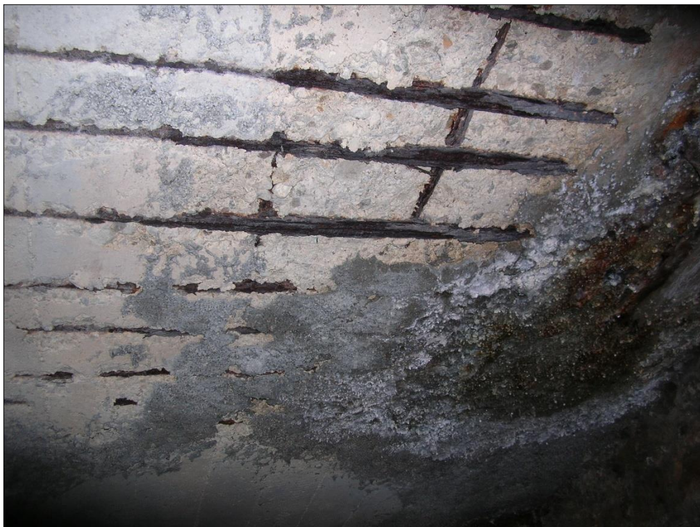
Foto 21: d15 – Ferri d'armatura a vista sul filo soletta.
