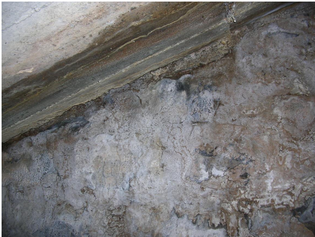
Foto 9: d4/d5 – Rottura lungo la parete del canale.
