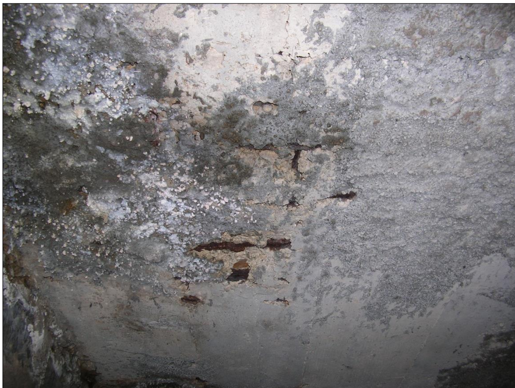
Foto 15: d11 – Ferri d'armatura a vista sul filo soletta.
