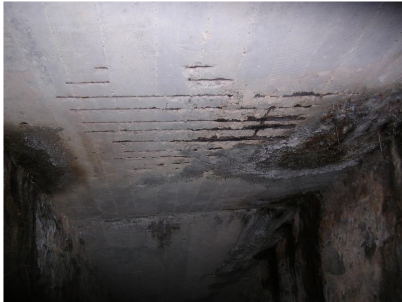
Figura 5: veduta di una porzione di soletta in cui manca il copriferro e le armature risultano visibilmente ossidate.
