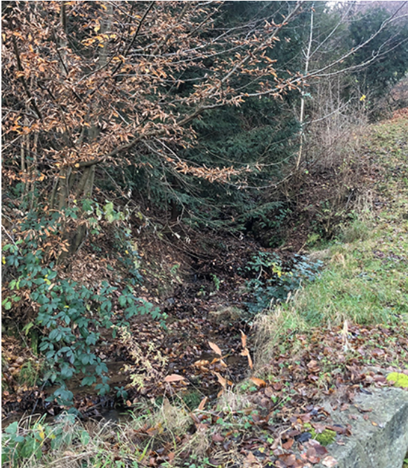
Immagine 11. Attraversamento tra zona agricola e zona edificabile in località i Mött.
